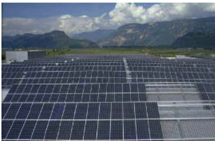
Figura 15 esempio di IMPIANTO FOTOVOLTAICO 304 kWp WürTH DI EGNA (BZ)
